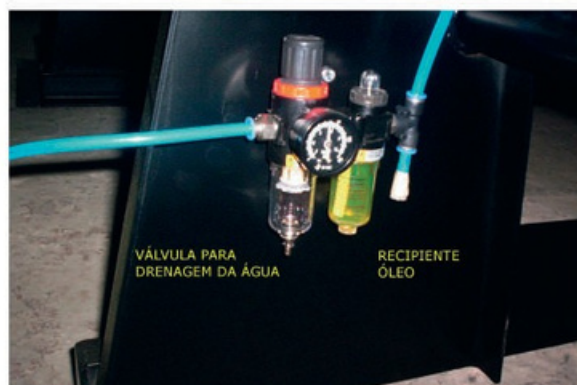
(FOTO 4: FILTRO LUBRIFIL)
