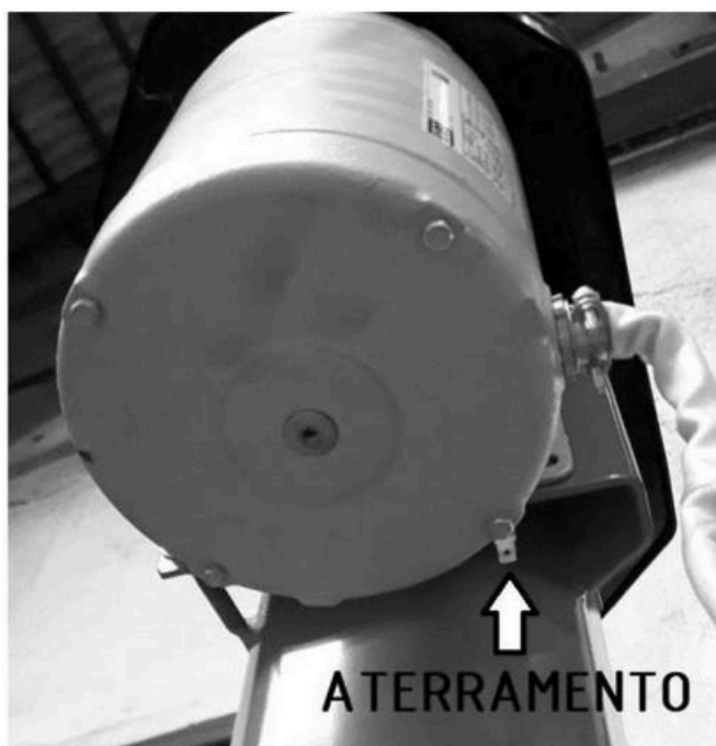
Ponto de aterramento do motor
