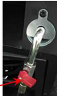
Válvula manual para descarga de óleo
