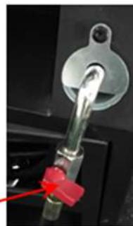
Válvula manual para descarga de óleo
