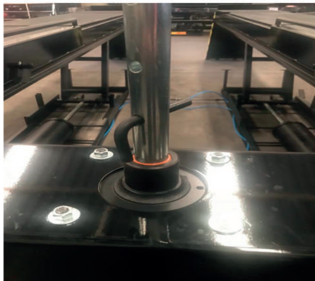
(FOTO 21: HASTE COM PINO APOIADO NA TAMPA)
